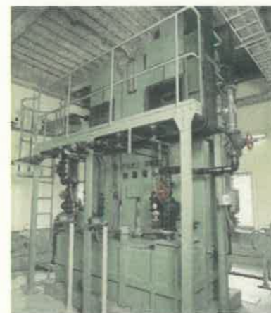
■酸・アルカリ次亜塩素酸脱臭塔
