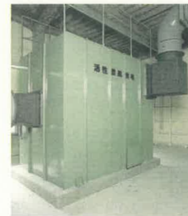
■活性炭脱臭塔
